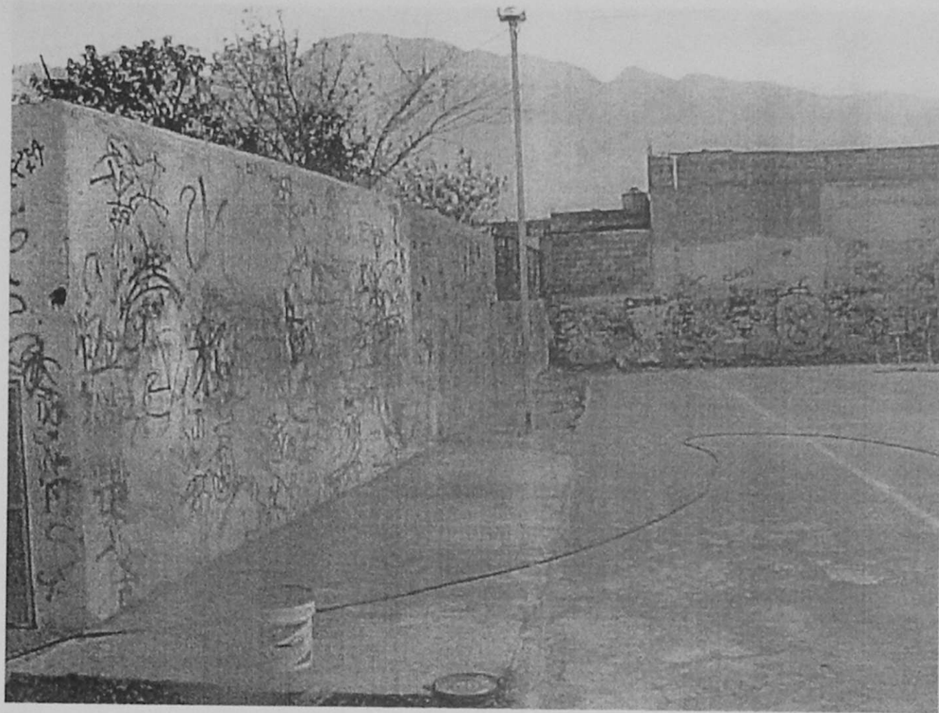
Parque en la Col. Los Sauces antes del mantenimiento.
